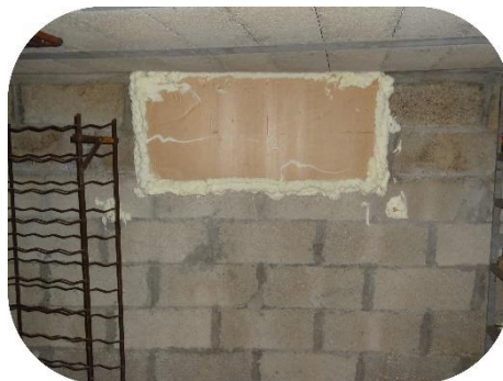
Mur de séparation entre la cave et le vide sanitaire obturé sommairement
